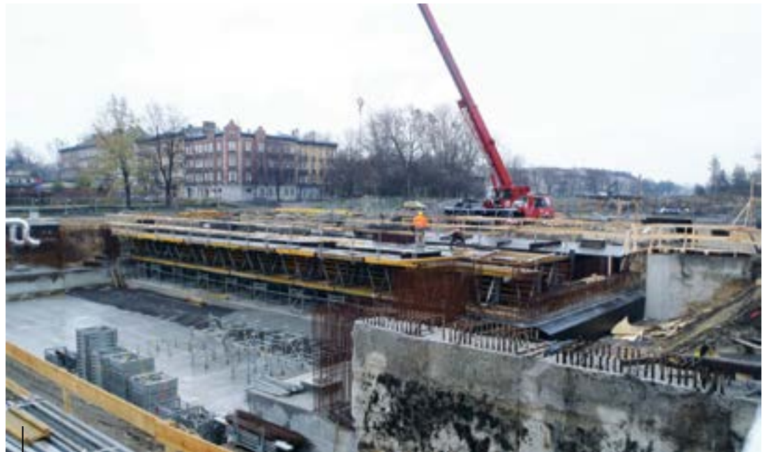
Sporo dzieje się także na odcinku G2. Trwa m.in. budowa wiaduktu i kładki dla pieszych, które połączą ulice Robotniczą i Franciszkańską...
