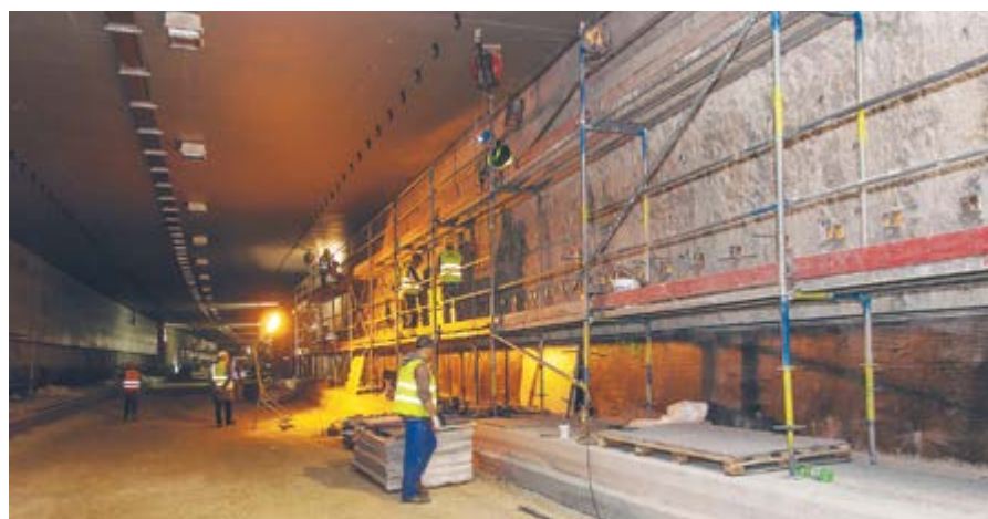
W tunelu pod ulicami Zwycięstwa i Dworcową montowane są okładziny ścian i wyposażenie
