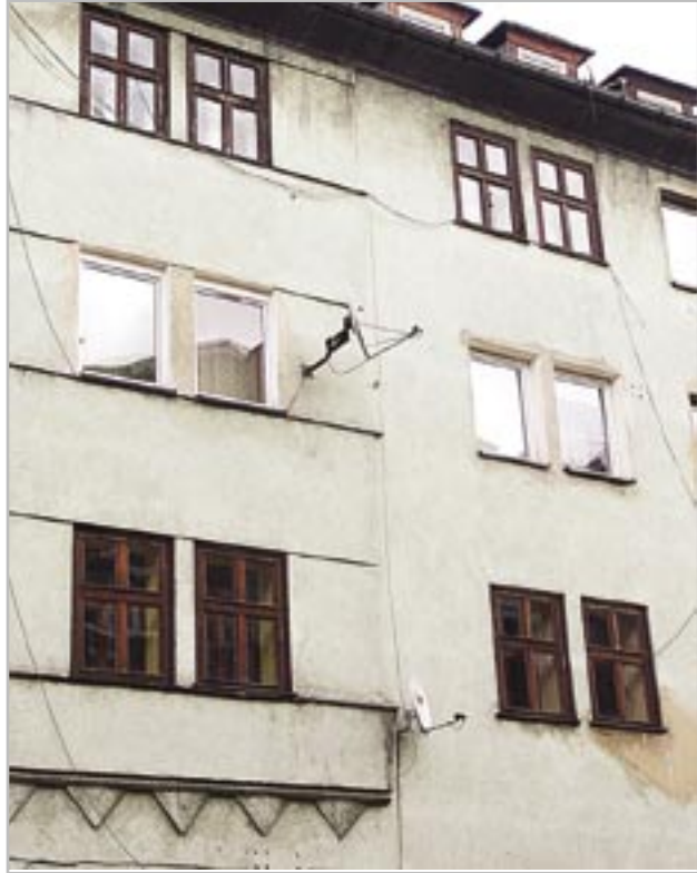
Efekt samowolnej wymiany stolarki okiennej w zabytkowej kamienicy
