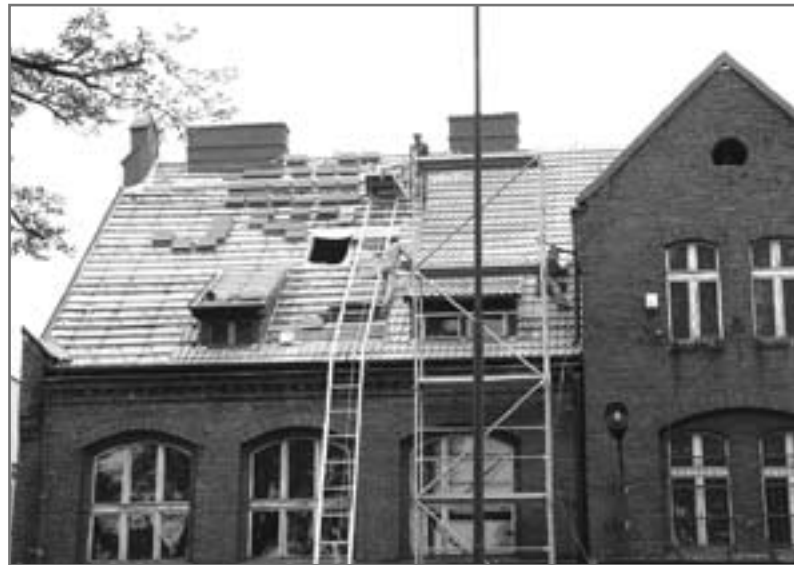
Naprawa dachu w SP nr 21 wymaga czasu
