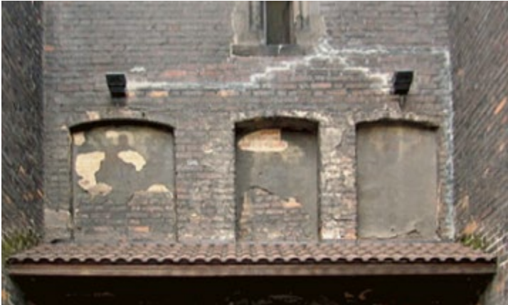
Stan przed konserwacją
